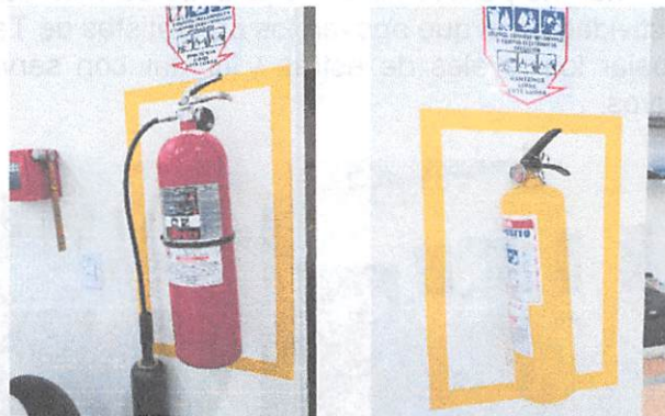
Extintores para líquidos inflamables o equipos electrónicos de operación (rojo) y para sólidos líquidos inflamables (amarillo)
